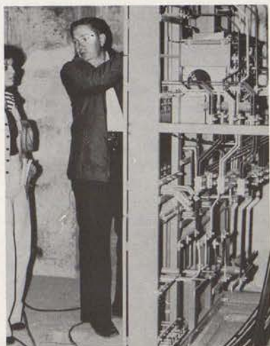
Interior do Quadro Geral de Força
