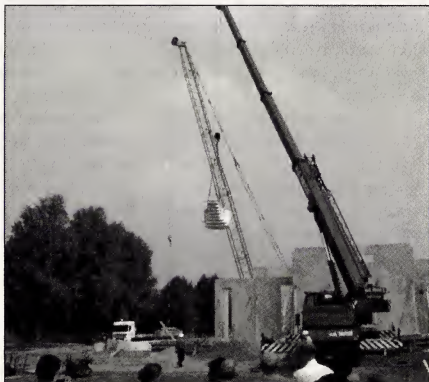
In juni is de doopvont geplaatst met behulp van een enorme bouwkraan.
