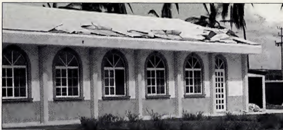
Krachtige winden van de orkaan Kenna hebben het dak van een kerkgebouw in Mexico beschadigd.
